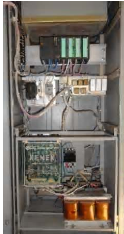
Рис. 3. Внутрішній вигляд переобладнаної шафи керування «Контур 1»
